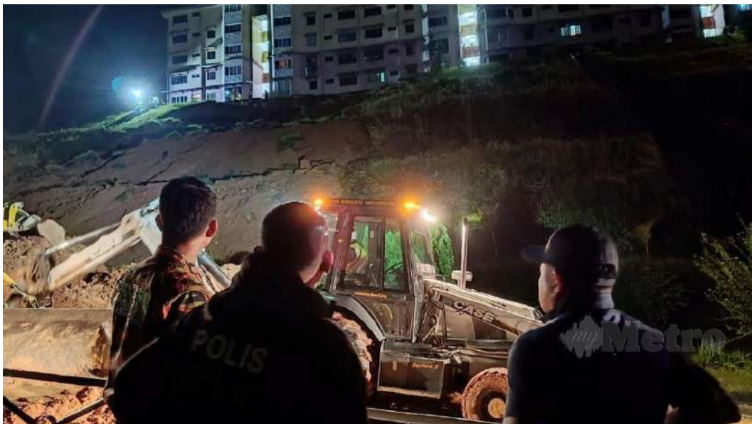
Tanah runtuh Apartmen Puncak Arabella, penduduk dibenarkan pulang.
